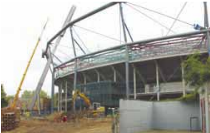
Die alten Flutlichtmasten sind noch im Einsatz
