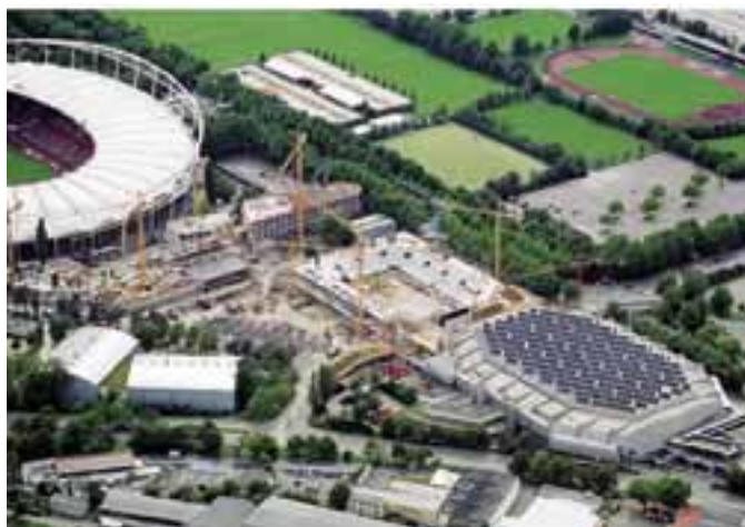
Das Bild zeigt den Stand der Arbeiten vor der Montage der Dachträger Foto: Euroluftbild
