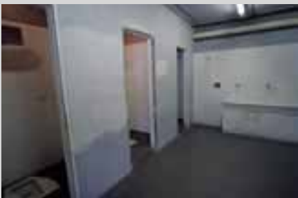
Sanitärbereich im Gästesektor: keine Türen
