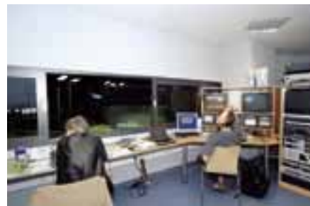
Zentrale der Medientechnik im Regieraum
