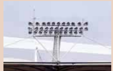
Flutlichter am Dachrand
