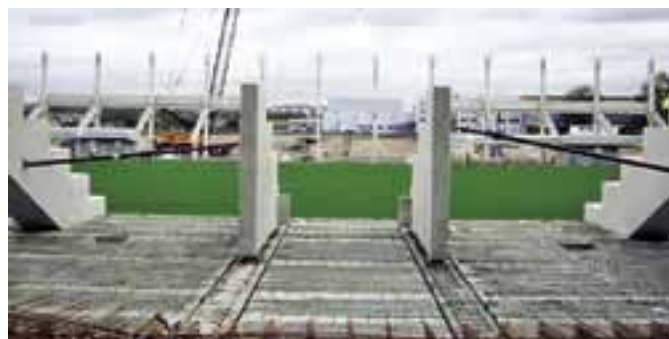
Baustelle mit Rasen. Die paragon arena kurz vor dem Baustopp im November 2005
