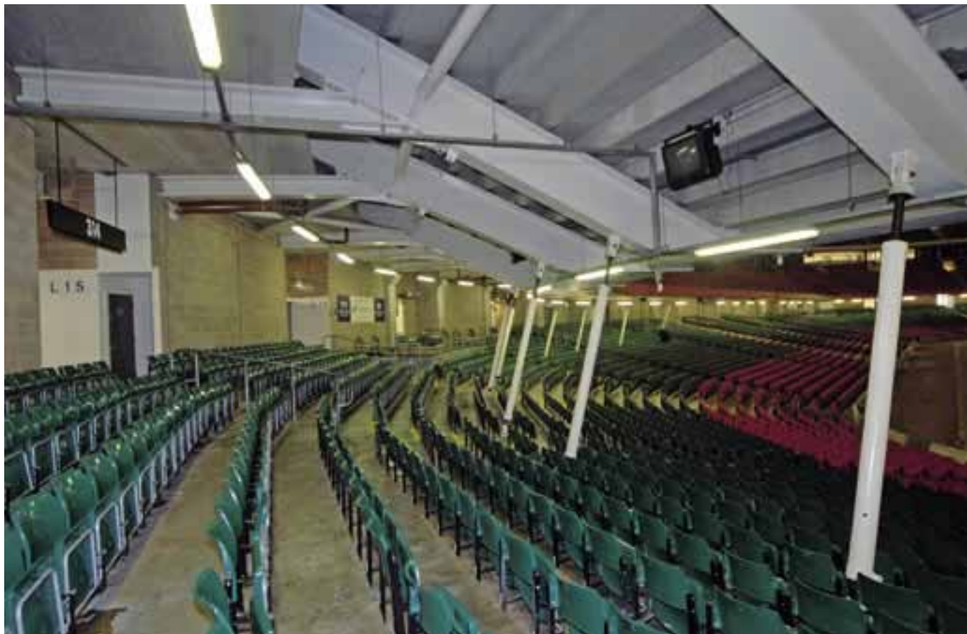
Nur für Konzerte installiert: Schwingungsdämpfer federn durch das Publikum und die Bässe erzeugte Vibrationen ab.
